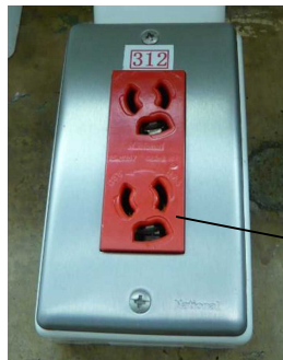
【写真4】西館発電機回路コンセント例
