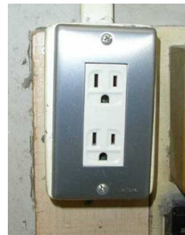
【写真5】西館商用回路コンセント例
