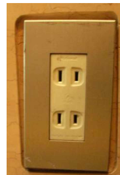
【写真7】別館商用回路コンセント例
