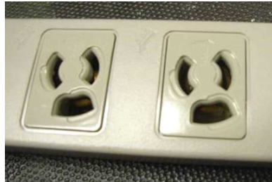
【写真2】東館発電機回路コンセント例
