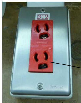
【写真4】西館発電機回路コンセント例
