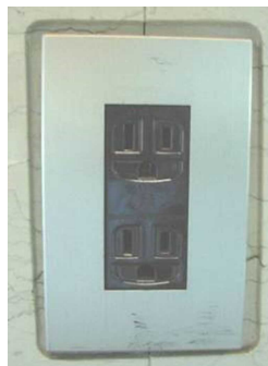
【写真6】別館発電機回路コンセント例
