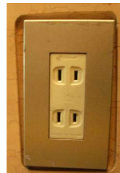
【写真7】別館商用回路コンセント例
