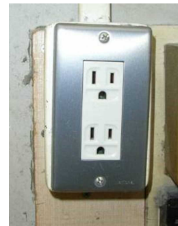
【写真5】西館商用回路コンセント例
