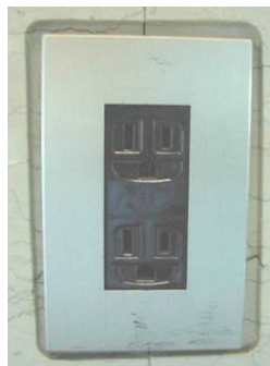
【写真6】別館発電機回路コンセント例
