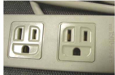
【写真3】東館商用回路コンセント例
