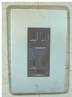
【写真6】別館発電機回路コンセント例
