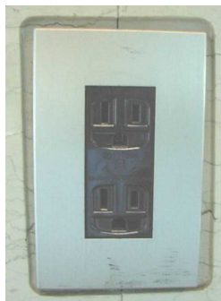
【写真6】別館発電機回路コンセント例
