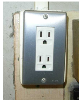
【写真5】西館商用回路コンセント例
