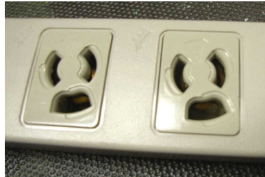
【写真2】東館発電機回路コンセント例
