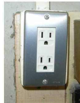
【写真5】西館商用回路コンセント例
