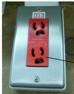
【写真4】西館発電機回路コンセント例
