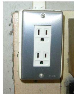
【写真5】西館商用回路コンセント例
