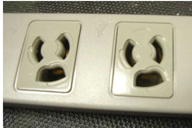
【写真2】東館発電機回路コンセント例
