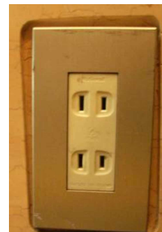
【写真7】別館商用回路コンセント例
