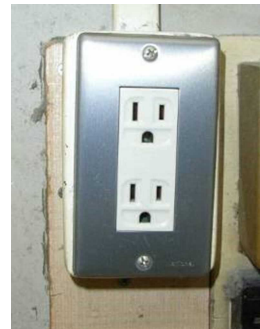
【写真5】西館商用回路コンセント例
