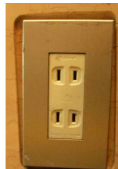
【写真7】別館商用回路コンセント例
