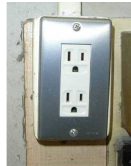
【写真5】西館商用回路コンセント例
