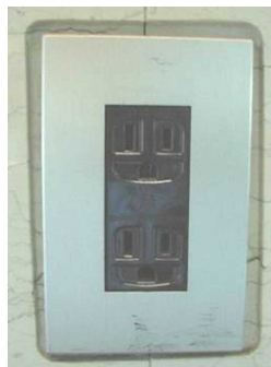
【写真6】別館発電機回路コンセント例
