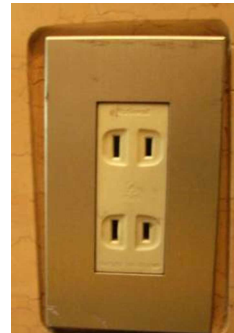
【写真7】別館商用回路コンセント例
