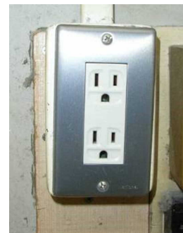
【写真5】西館商用回路コンセント例
