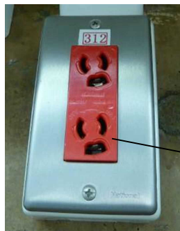
【写真4】西館発電機回路コンセント例
