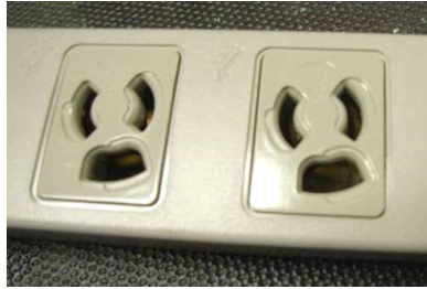
【写真2】東館発電機回路コンセント例
