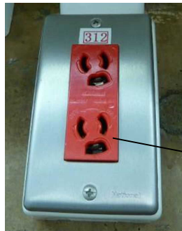
【写真4】西館発電機回路コンセント例
