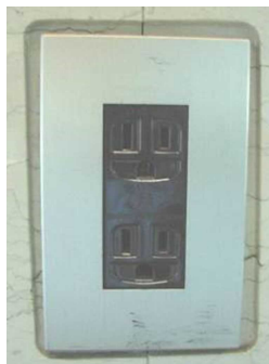
【写真6】別館発電機回路コンセント例
