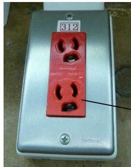
【写真4】西館発電機回路コンセント例
