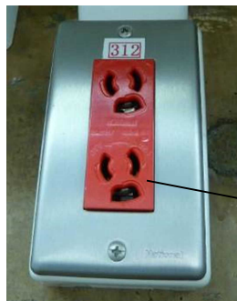
【写真4】西館発電機回路コンセント例
