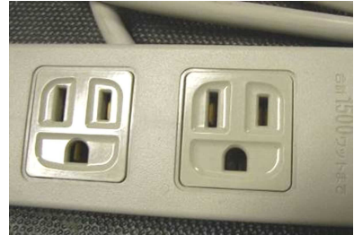
【写真3】東館商用回路コンセント例
