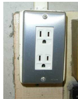
【写真5】西館商用回路コンセント例
