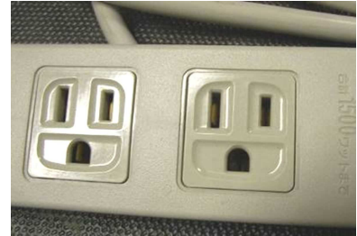
【写真3】東館商用回路コンセント例
