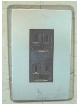
【写真6】別館発電機回路コンセント例
