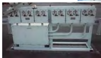
第1バース リーファーコンセント192口（整備済み） 第2バース リーファーコンセント 96口（H30整備完了）
