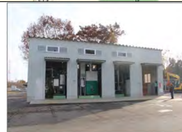
間伐材チップを活用するバイオマスプラント
