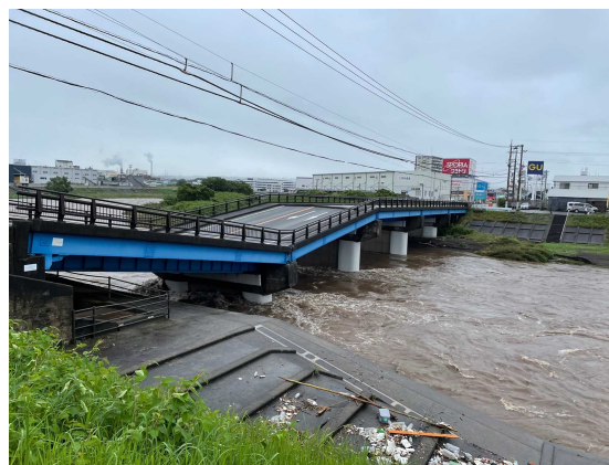
■ 令和3年7月豪雨での被害（黄瀬川）
