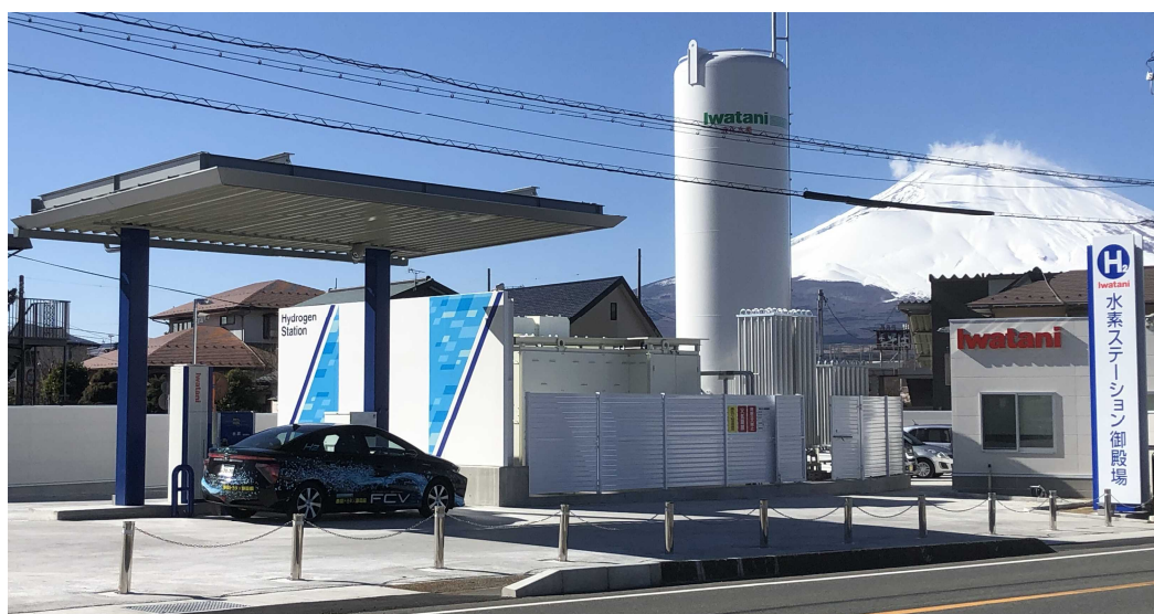
イワタニ水素ステーション 御殿場インター（令和元年度整備）
