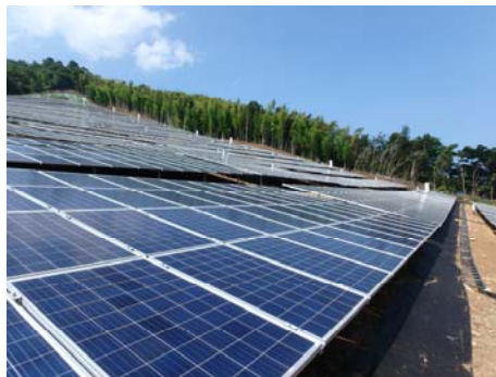
太陽光発電施設
