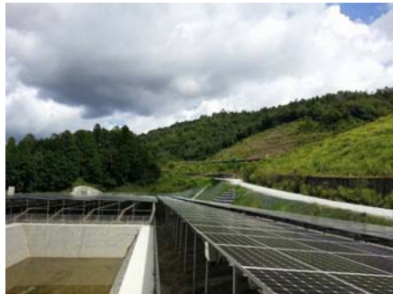
太陽光発電施設
