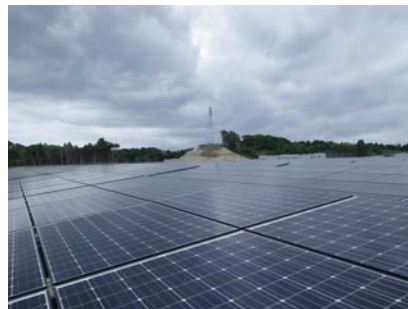
太陽光発電施設
