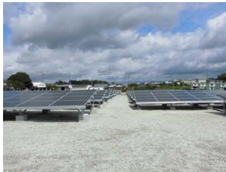
太陽光発電施設
