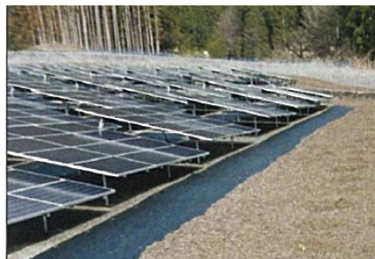
太陽光発電施設
