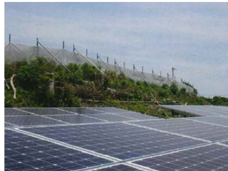
太陽光発電施設
