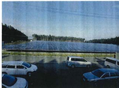
太陽光発電施設
